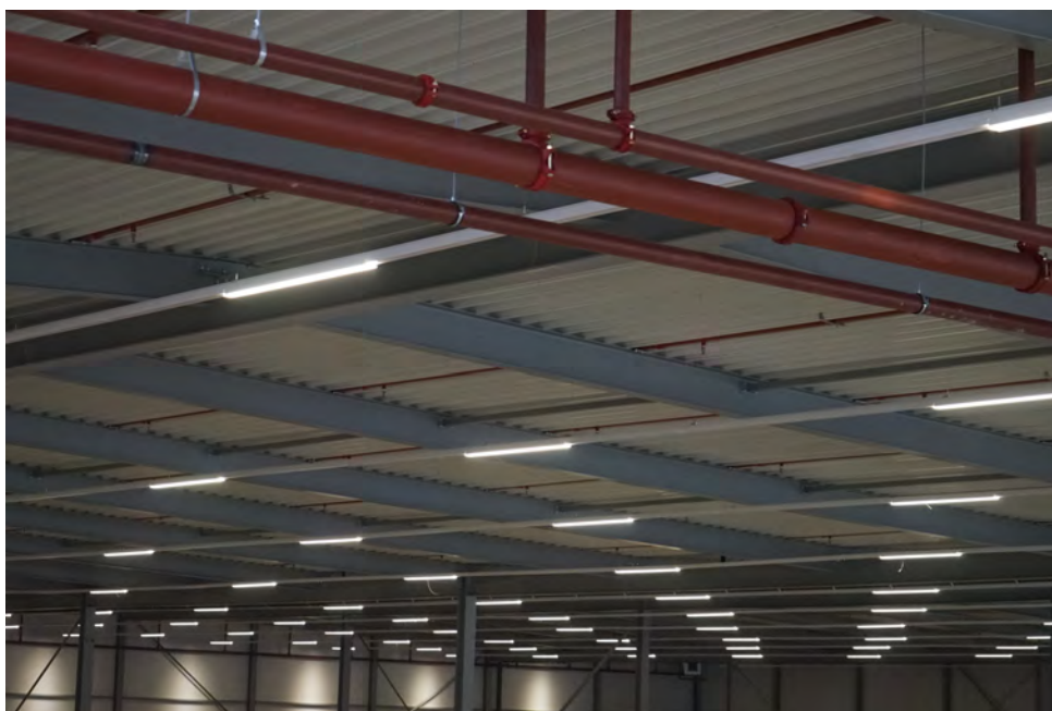
LED Beleuchtung in der Lagerhalle
