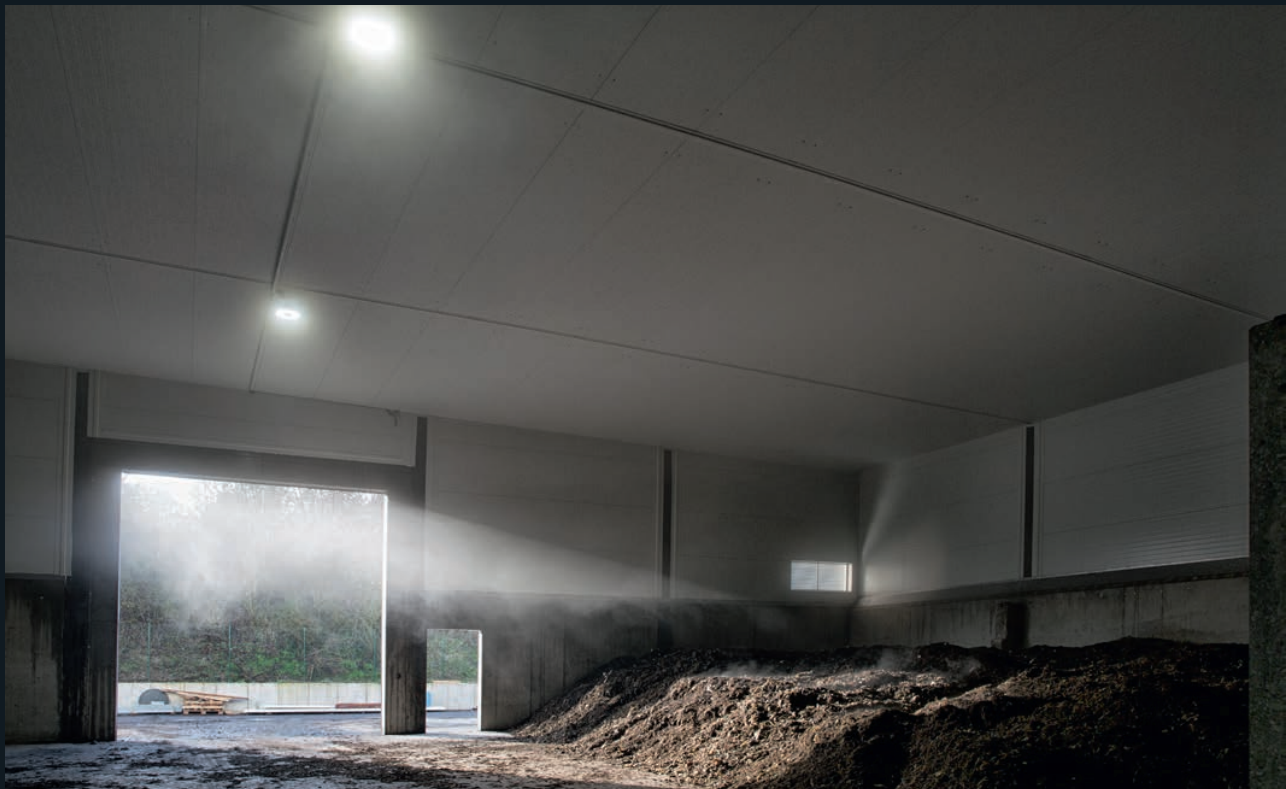
BVB Westheim Kompostieranlage
